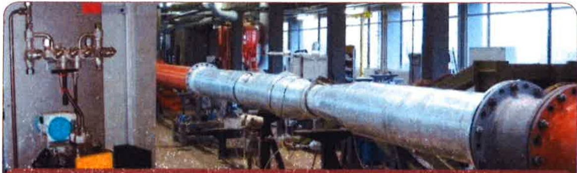
Höyrymittauksen kalibrointi venturiputkelle DIN EN ISO 5167 mukaan. METRA Energie-Messtechnik Speyer. Välilaine: Höyry, massavirta 65 t/h, höyryn paine 21 bar(a), höyryn lämpötila 280 °C
